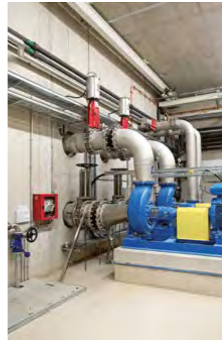
Die Pumpen im Keller befördern das Wasser aus dem Rücklaufbecken in die Behälter im Dachgeschoss des Gebäudes.
